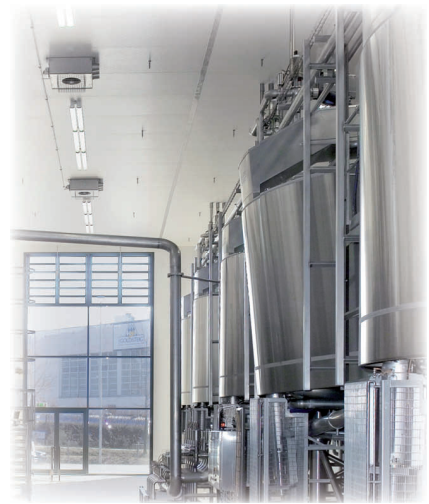
Kanallose Lüftungsgeräte HACIS sorgen für zugfreie Klimatisierung in der Goldsteig-Produktion. Werksfoto
