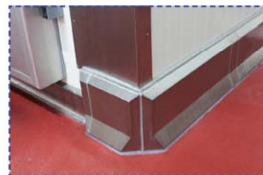
PolySto OP20F Edelstahl auf einem Epoxyboden montiert.
